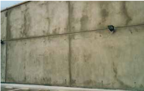
Hormigón nuevo con ligeras manchas
