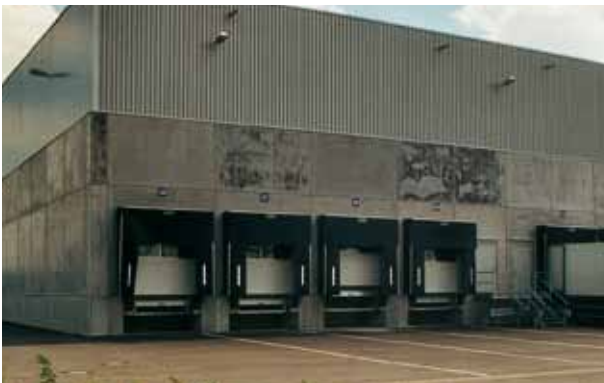
Hormigón nuevo con manchas importantes
