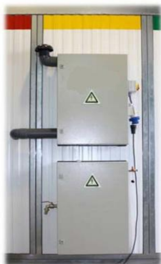
Fig.9. Quadro eléctrico e quadro hidráulico.
